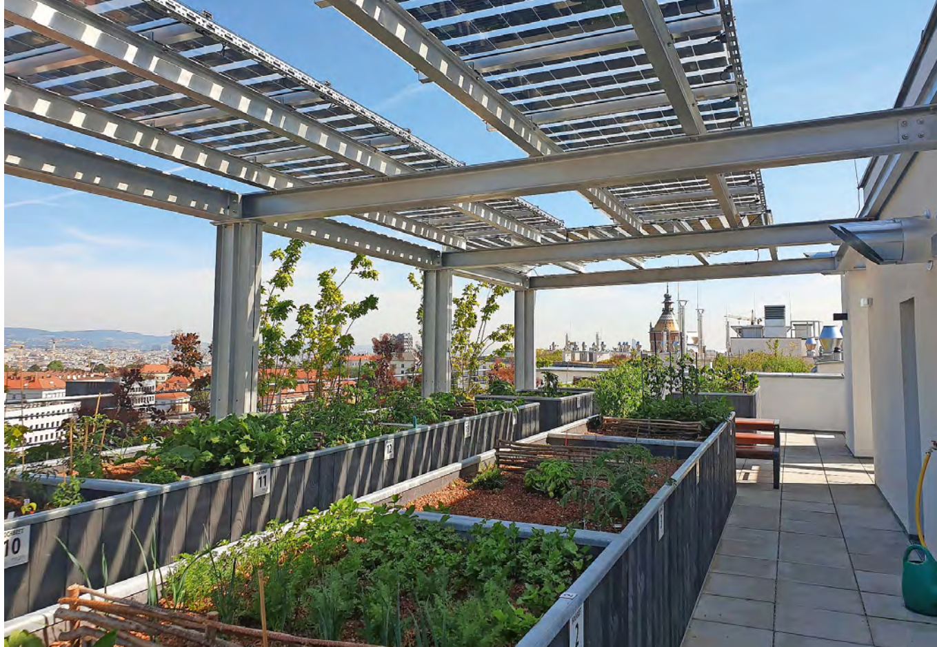
Biotope City Wienerberg: Kombination von Photovoltaik und Urban Gardening auf dem Dach
